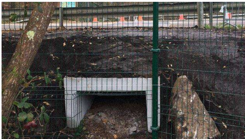
Figura 6.8.- Paso subterráneo de fauna bajo la carretera AC-221 (ZEC Cecebre-Abegondo. Término Municipal de Cambre, A Coruña). Reserva de Biosfera Mariñas Coruñesas e Terras do Mandeo.
